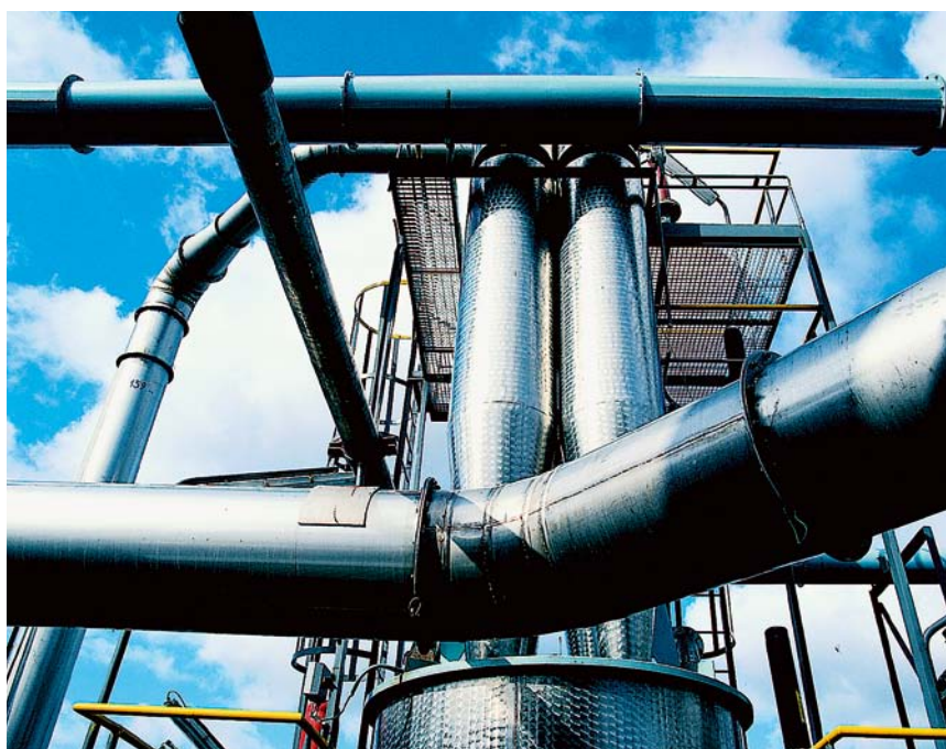
Begehbare Stege aus Stahlrosten
